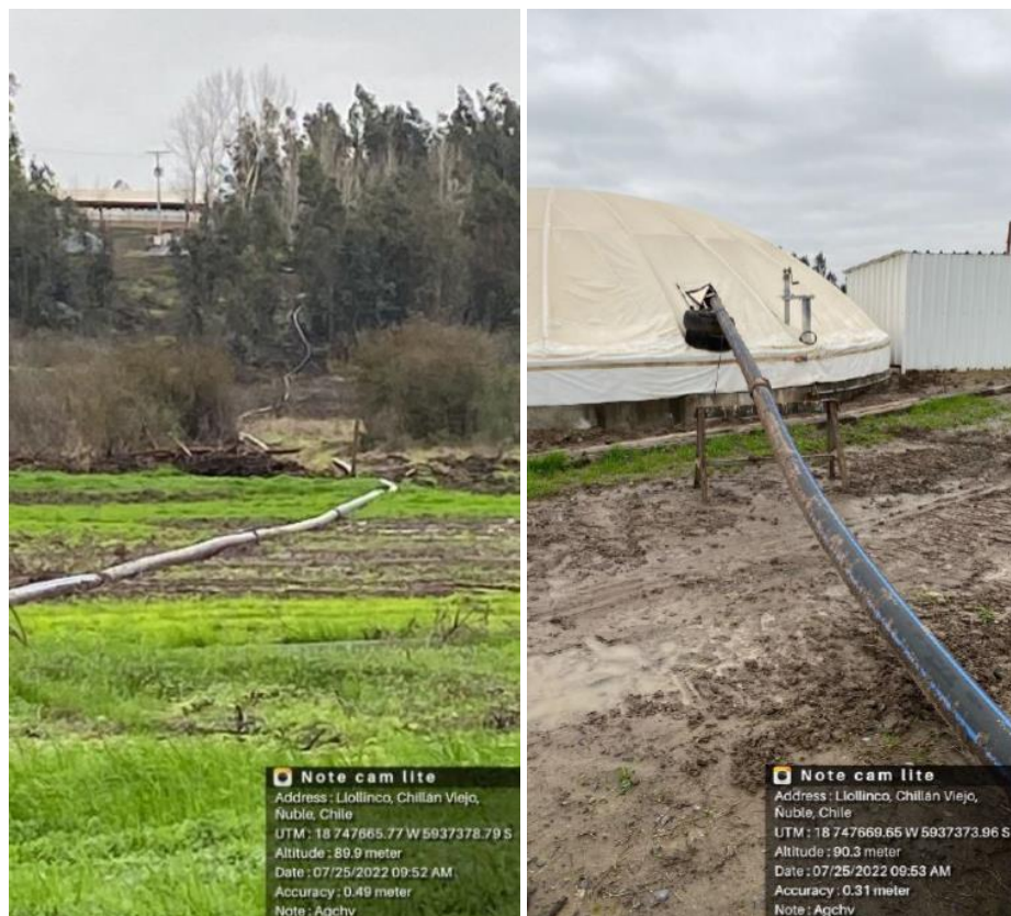
Figura 32: Tubería de contingencia
