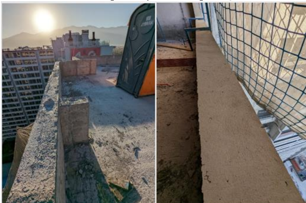
Figura 1: Coronación de obra gruesa (piso 18) y tratamiento de rasgos de puertas y ventanas (piso 15)
