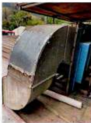
Vex cámara de grasa marquesina patio de descarga
