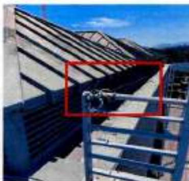
Vex Suite 2271/2272, Vex cocina piso 21 Sala de maquinas piso 23
