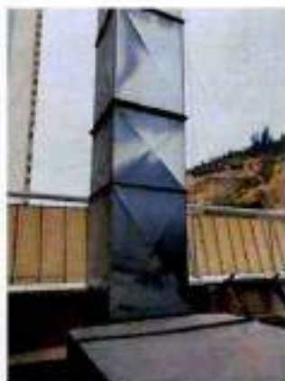
Vex Palafito sobre Marquesina patio de descarga
