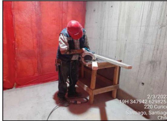
Sierra Circular operando en sala con tratamiento acústico
