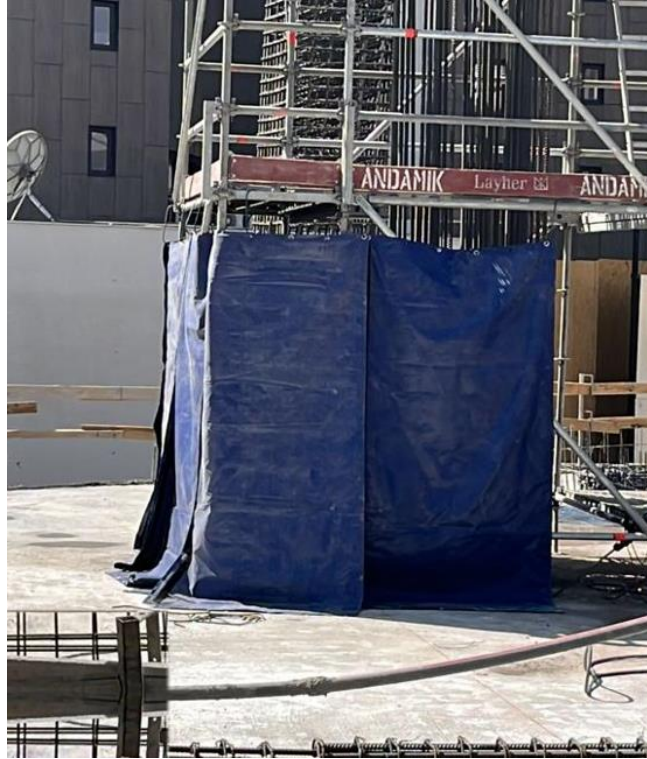
Mantas acústicas para uso de herramientas potencialmente ruidosas
