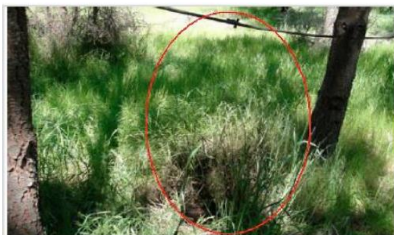
Fotografía 17. Vista de la línea de riego donde se ubica uno de los aspersores. Bajo el aspersor se observa vegetación muerta.
