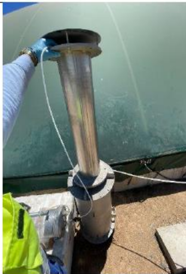
(b) Válvula de Seguridad de Sobre Presión y Baja Presión BAUR (Biodigestor) (15-12-2022).
