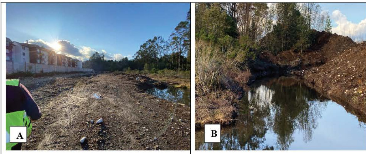
Fotografía 7: A) Se observa en Lote 3-b-1 y 3-b-2 despeje de vegetación, y compactación de suelo; B) Se observa zanja con agua al nivel del suelo, que da cuenta de la saturación del suelo, además, de acopio del suelo removido en sector lote 3-b-1.
