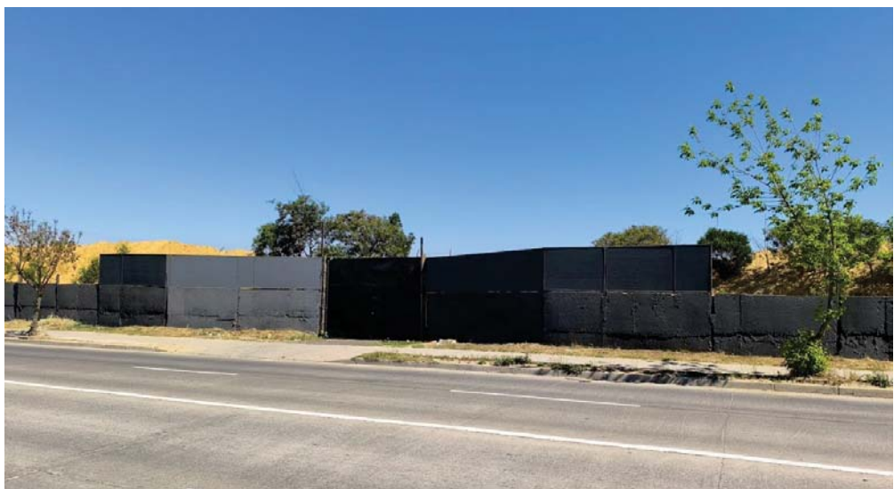
Instalación de barrera acústica en el portón de acceso N° 2 del CADQ
