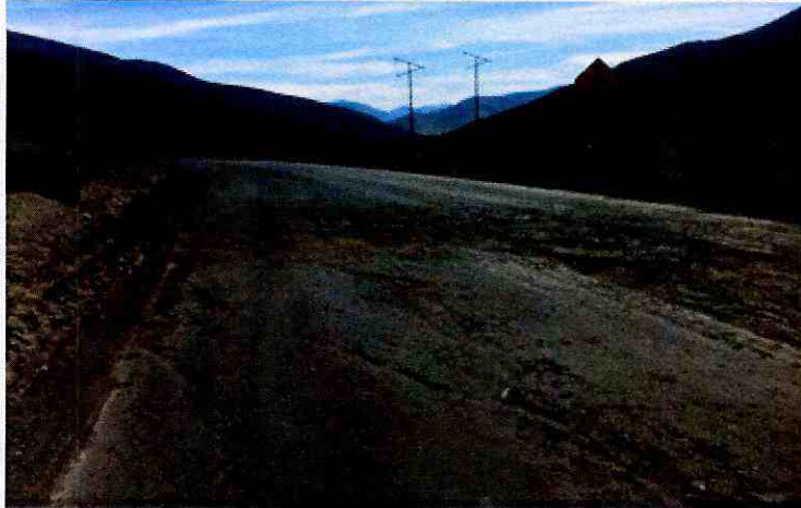
Figura N° 2: Sectores con baches en la carpeta de bischofita de la Ruta C-397.
