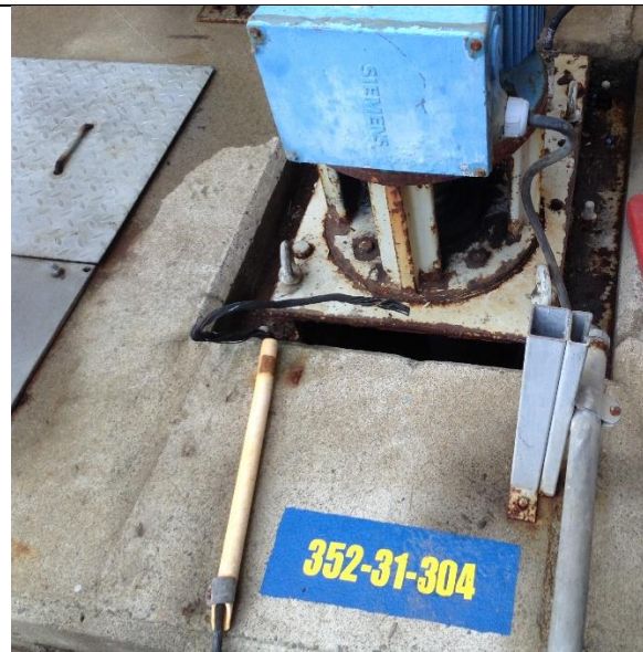
Fotografía N° 4: Detalle de Bomba Siemens, implementada en Foso N° 4, identificada como equipo 352-31-304, que corresponde a bomba M304.
