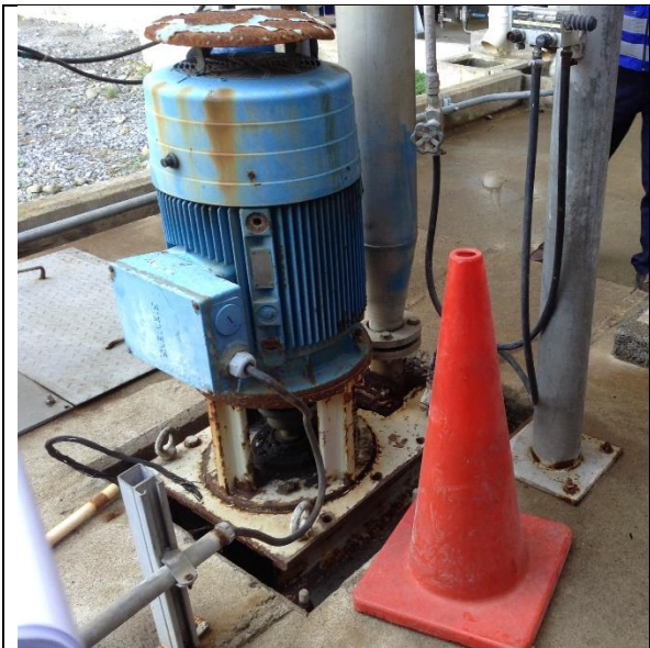
Fotografía N° 3: Bomba marca Siemens implementada en Foso N° 4.
