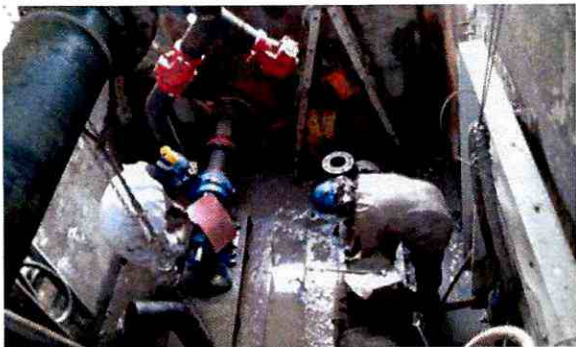
Fotografía 1, instalación bombas Leader 1 y 2
