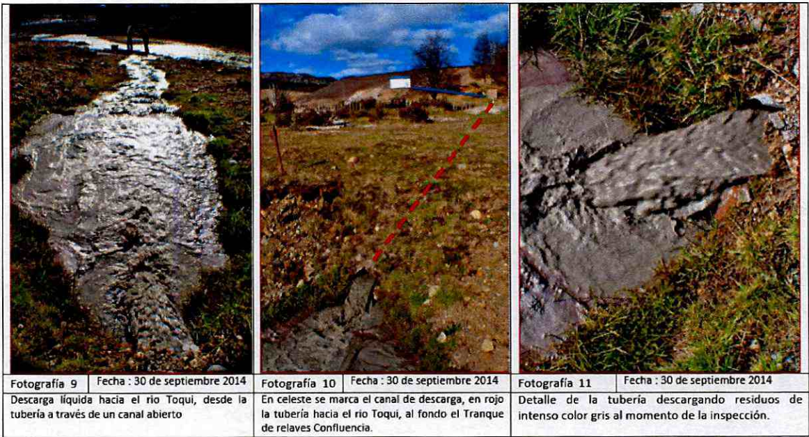
Fotografía N° 2: Tubería de descarga de RILes desde el TRC hacia el río Toqui.
