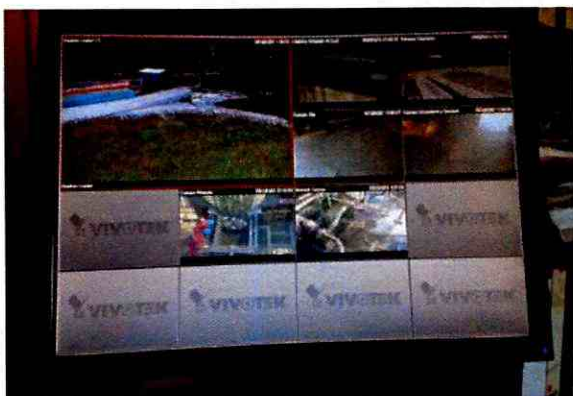
Fotografía 12, monitoreo on-line desde sala de control
