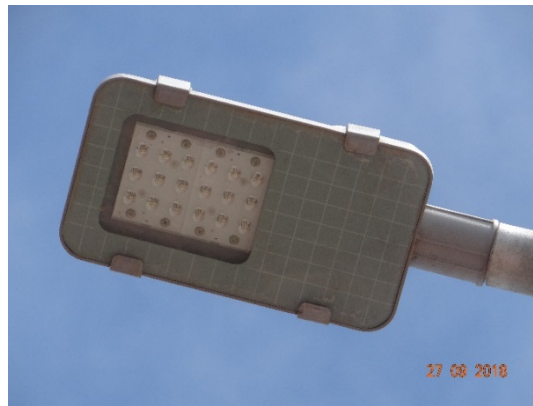
Imagen 2. Luminaria en poste solar modelo TAHAA 40W
