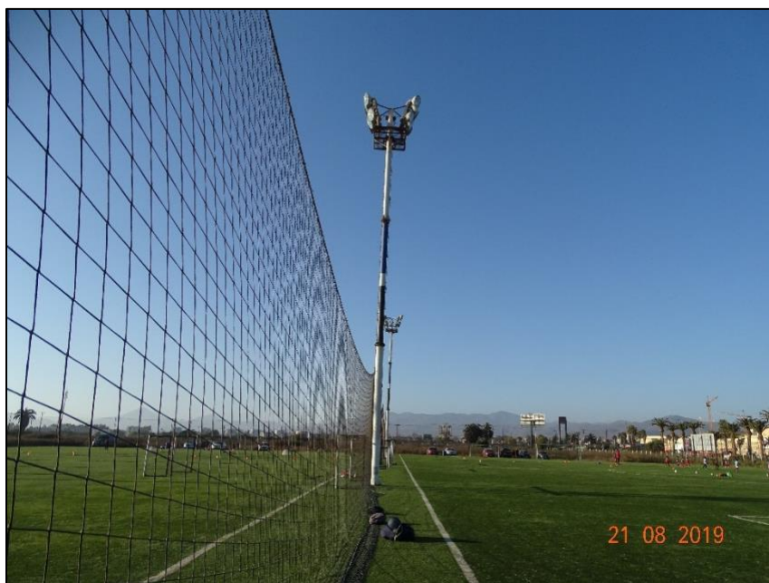
Imagen 2. Acercamiento sistema de alumbrado deportivo.
