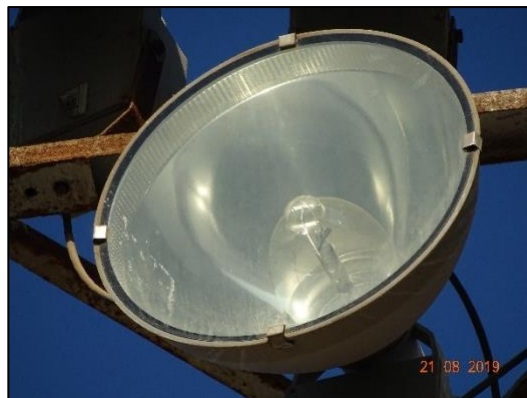
Imagen 4. Vista de detalle luminarias Canchas Toronto Eagles.
