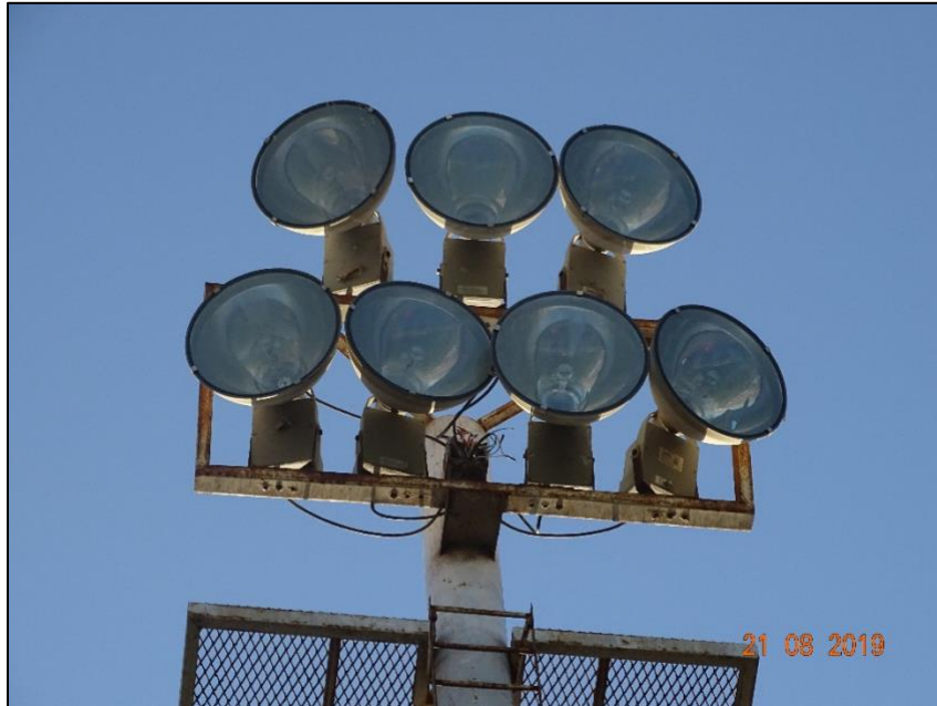
Imagen 3. Acercamiento luminarias sobre poste.
