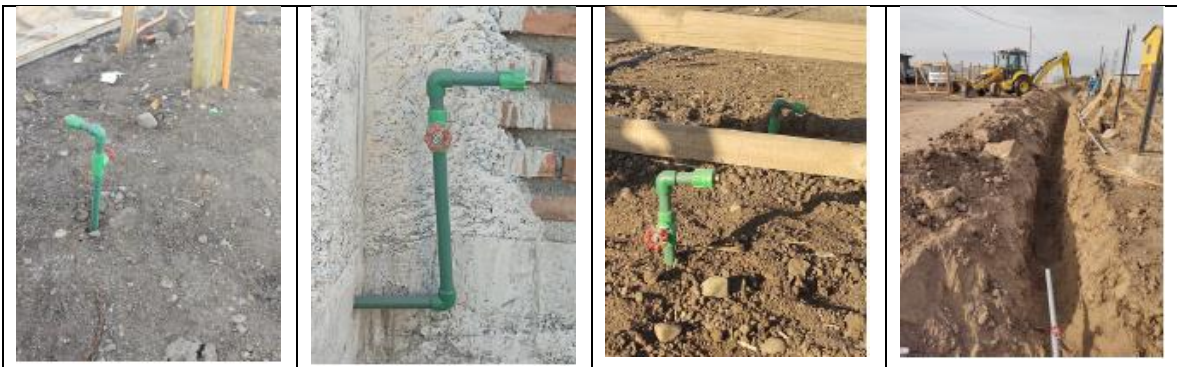
Imagen N° 12. Instalación de abastecimiento de agua
