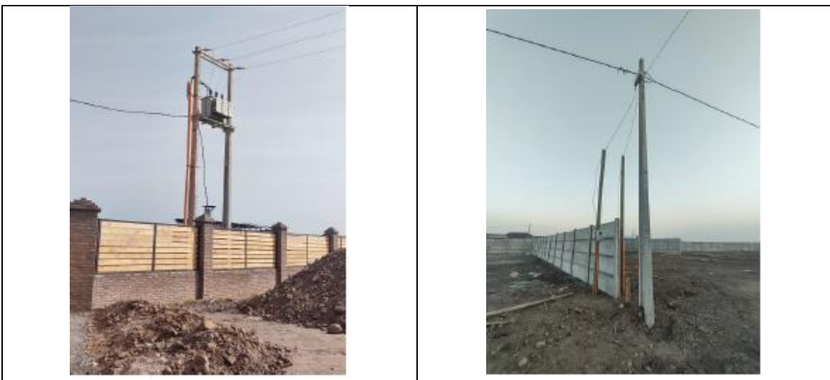
Imagen N° 11. Suministro de energía eléctrica
