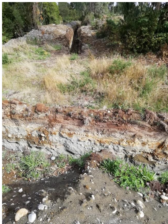
Imagen N° 32: Canal perimetral sector oeste, se encuentra incompleto
