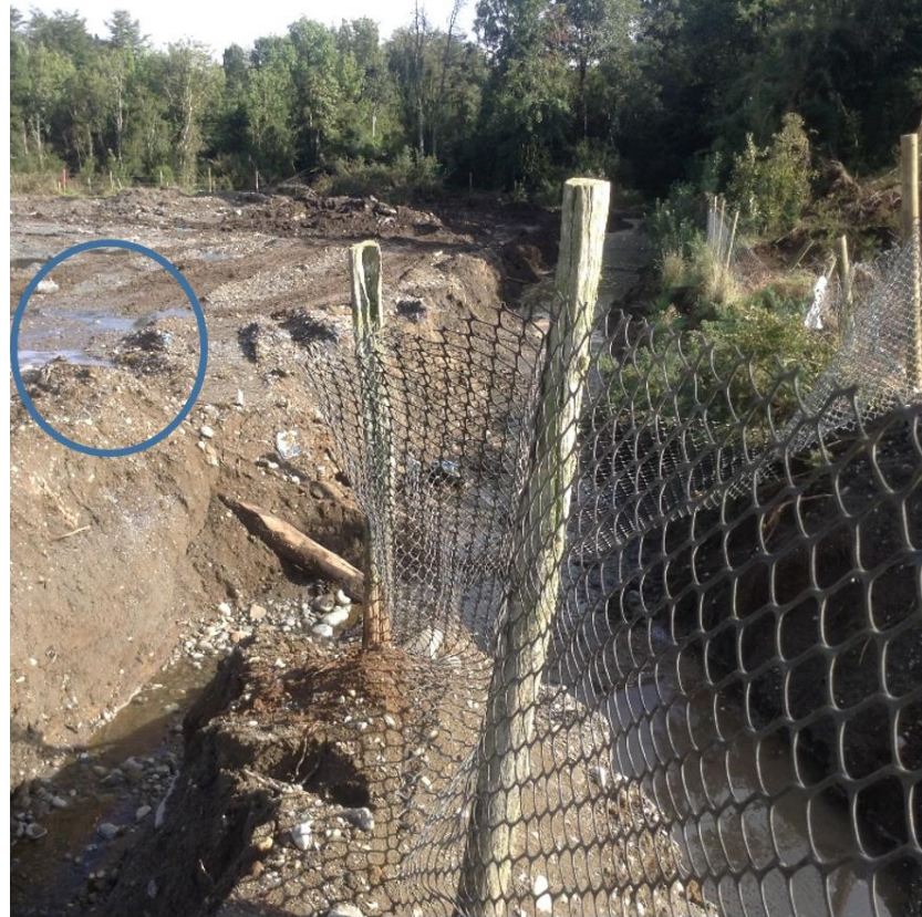
Imagen N° 50: Presencia de aposamiento de lixiviados al borde de la zanja perimetral de aguas lluvias
