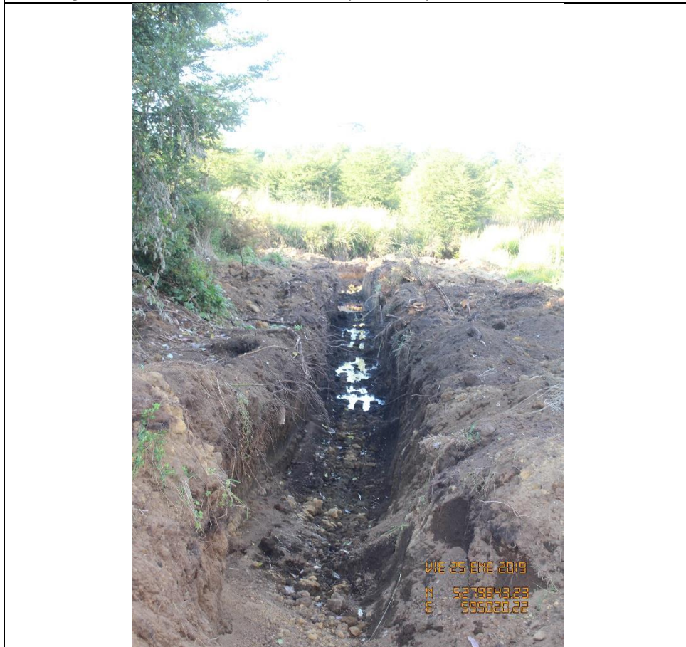
Imagen N° 31: Sección de canal perimetral que no cumple con dimensiones autorizadas
