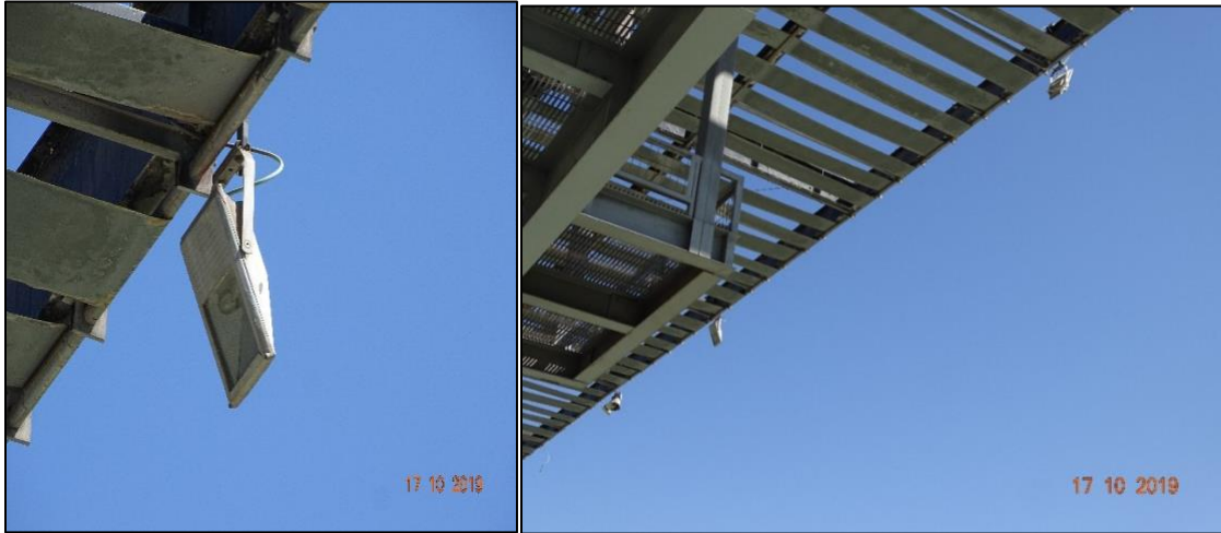
Imagen 1. Vista general y acercamiento luminarias en sector butacas, con tecnología de haluro metálico (Luminarias N° 2).
