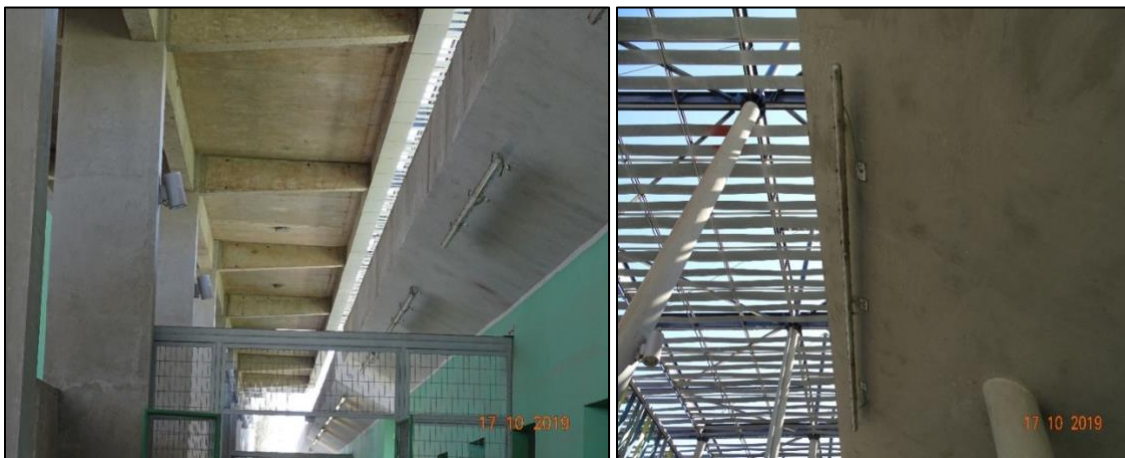
Imagen 3. Vista general y acercamiento luminarias en sector pasillo baños (Luminaria N° 5).
