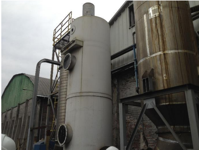
Imagen 4. Vista sistema de lavado de gases.
