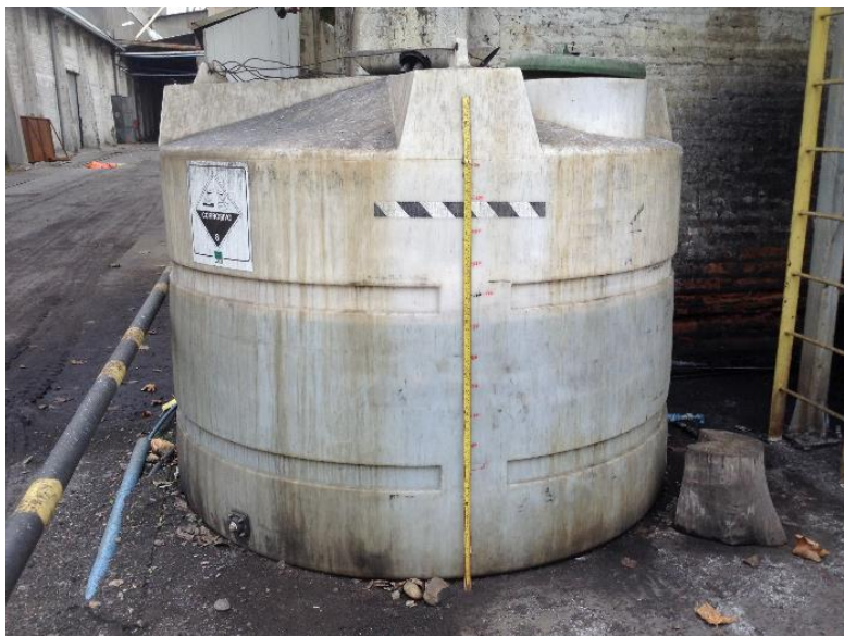
Imagen 5. Vista estanque de soda cáustica adicionada al agua de lavado de gases.
