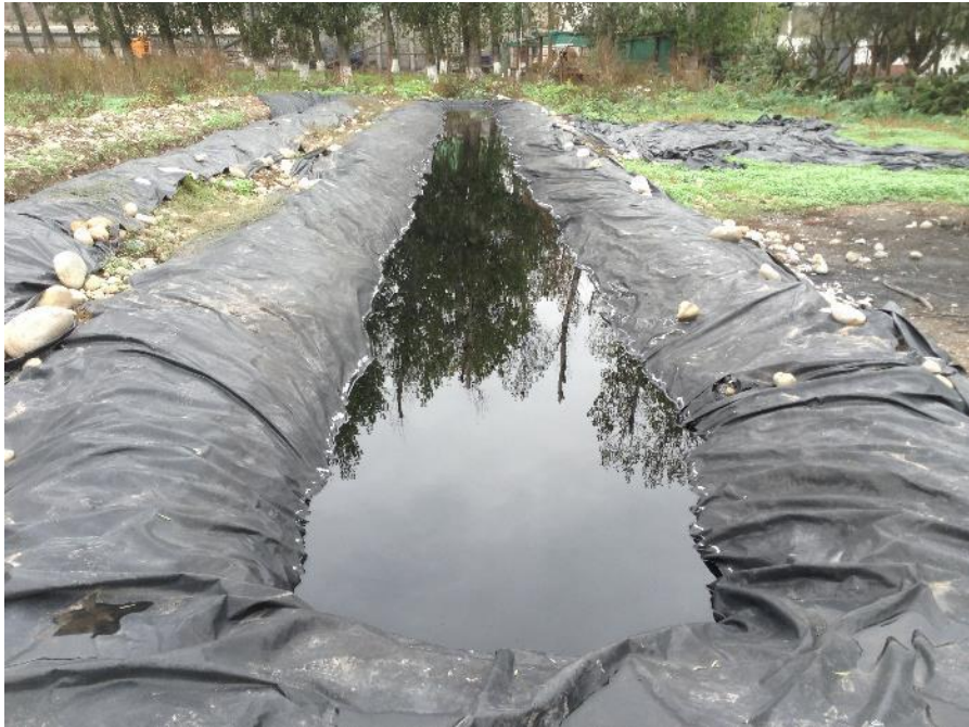
Imagen 6. Vista piscina de acumulación de riles lavado de gases.
