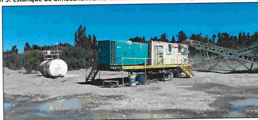
Imagen 5: Estanque de almacenamiento de combustible Diesel sin pretil de seguridad asociado
