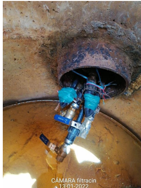
Imagen 5. Sistema de detección de fugas de la piscina TK-10, registrada por la SMA en muestreo de fecha 13-01-2022
