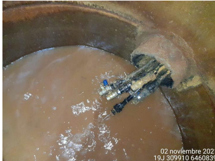
Imagen 4. Válvulas terminales en cámara de inspección del Sistema de detección de fugas en piscina TK-10
