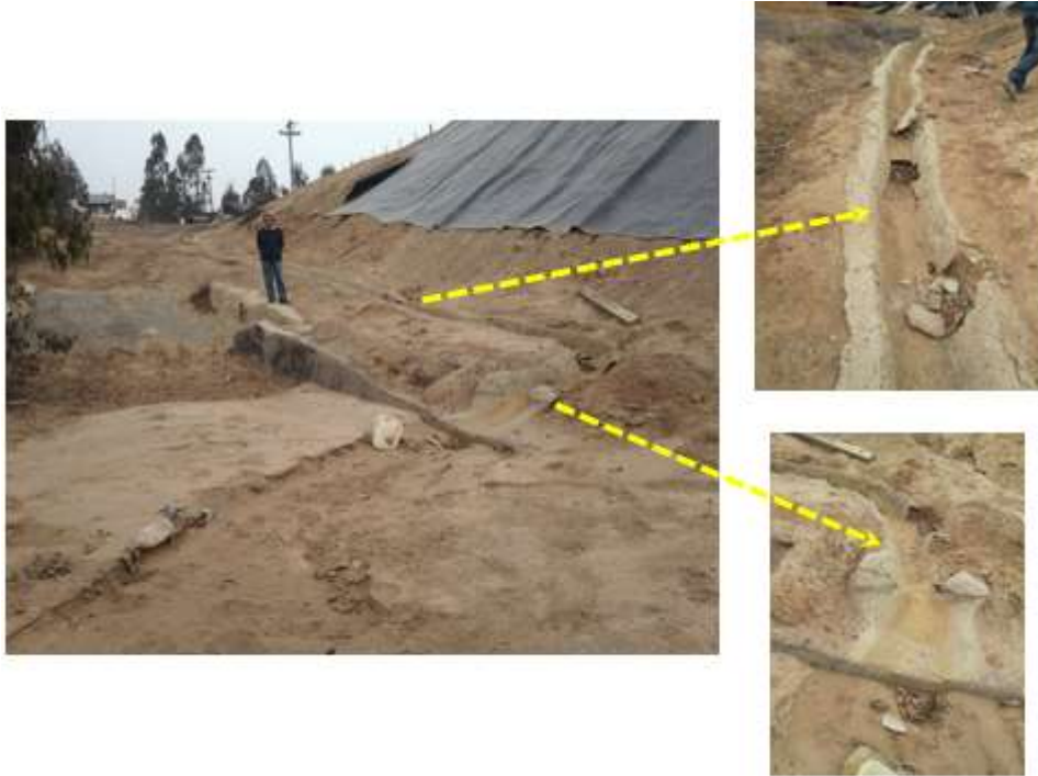
Imagen 5. Canaleta conductora de aguas lluvia deteriorada.
