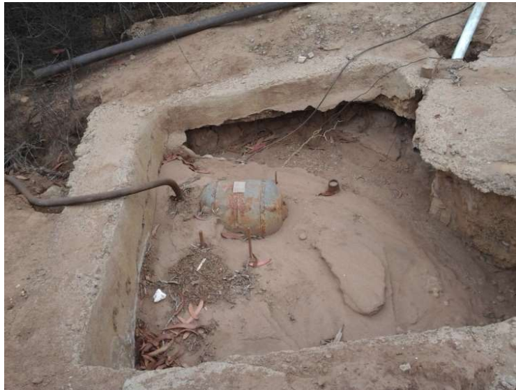
Imagen 6. Bomba de impulsión embancada.
