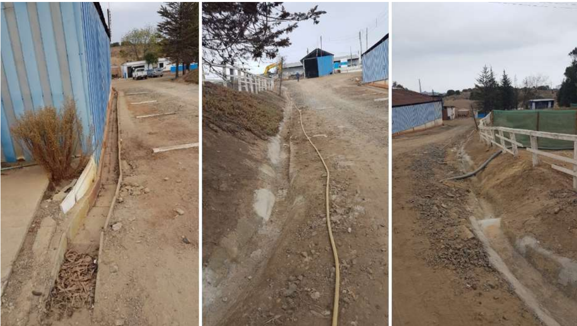
Imagen 25. Canaletas de conducción de aguas lluvias de Planta de Minera Montecarmelo
