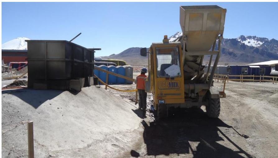
Imagen 10. Abastecimiento de agua caliente a camión mixer, para la preparación de hormigón desde contenedor de fierro.
