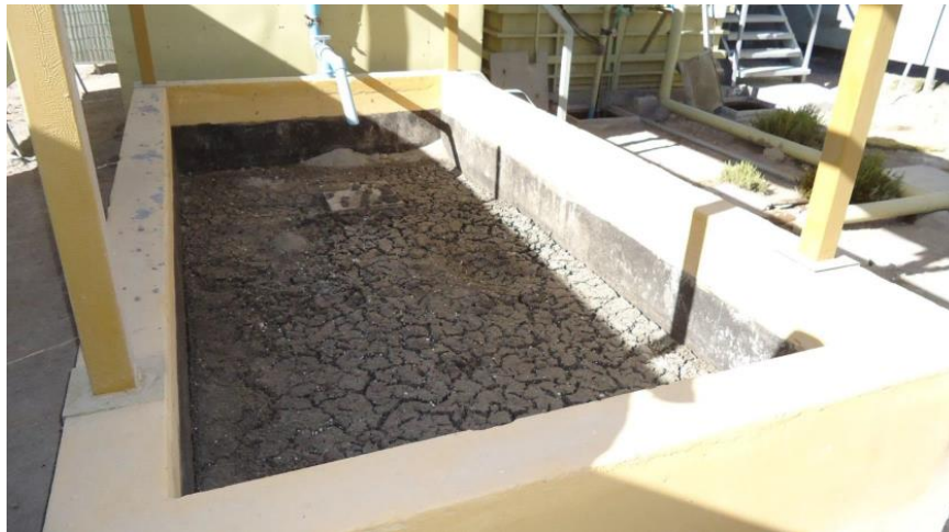
Imagen 5. Cancha de secado de lodos
