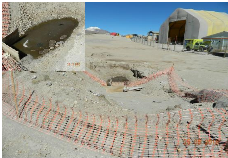
Imagen 9. Pozo de acumulación de aguas servidas
