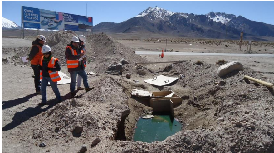
Imagen 8. Pozo de acumulación de aguas servidas
