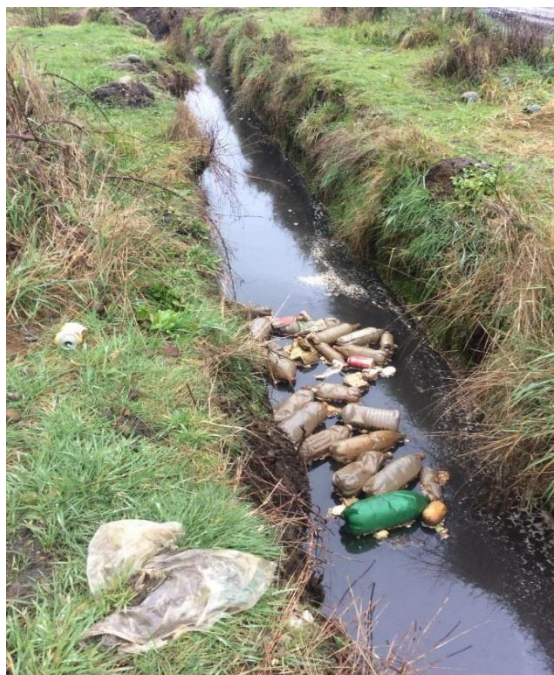
Imagen 4. Zanja provisoria con presencia de residuos plásticos y lixiviados, septiembre de 2018
