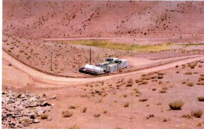
Figura N°2.2.4.2.1. Generador de Energía Eléctrica, Campamento Rancho del Gallo
