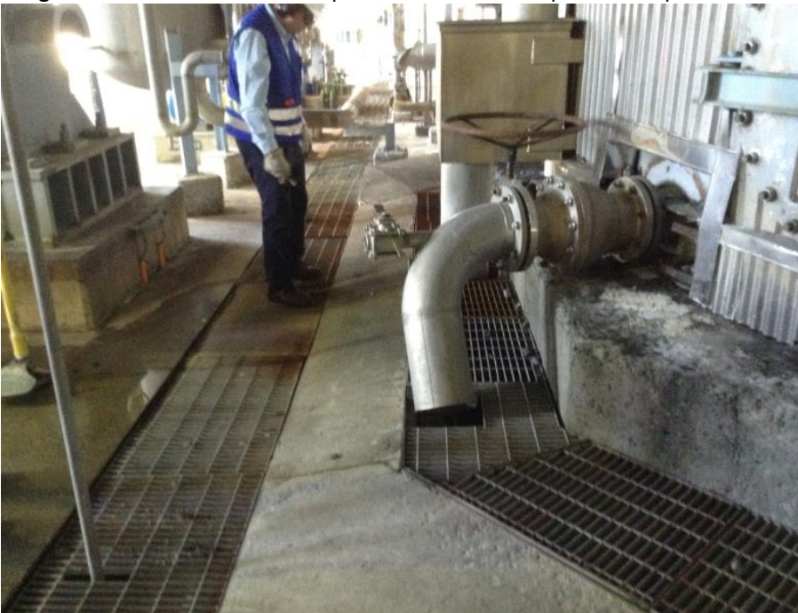
Imagen N°5: Acometida del estanque disolvedor al canal perimetral que conduce a foso N°4.
