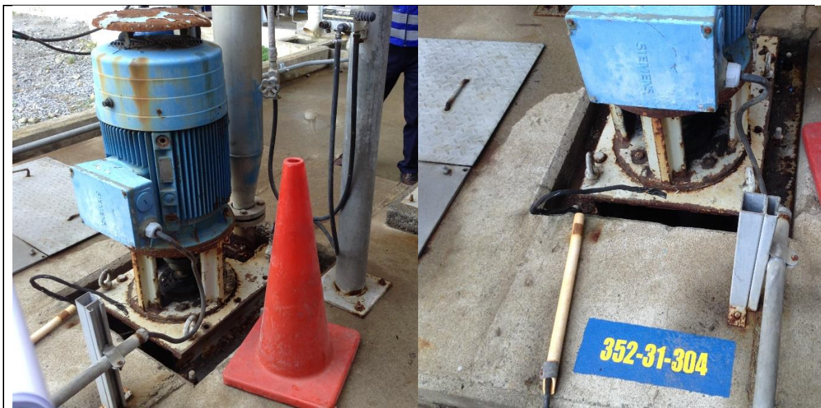
Fotografía N° 3: Bomba marca Siemens implementada en Foso N° 4. Fotografía N° 4: Detalle de Bomba Siemens, implementada en Foso N° 4, identificada como equipo 352-31-304, que corresponde a bomba M304.
