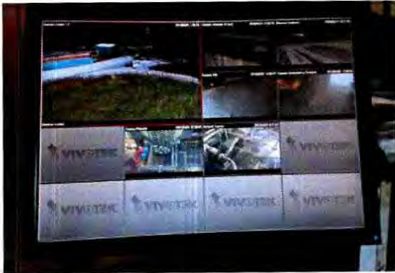
Fotografía 12 , monitoreo on-line desde sala de control
