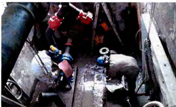
Fotografía 1 , instalación bombas Leader 1 y 2
