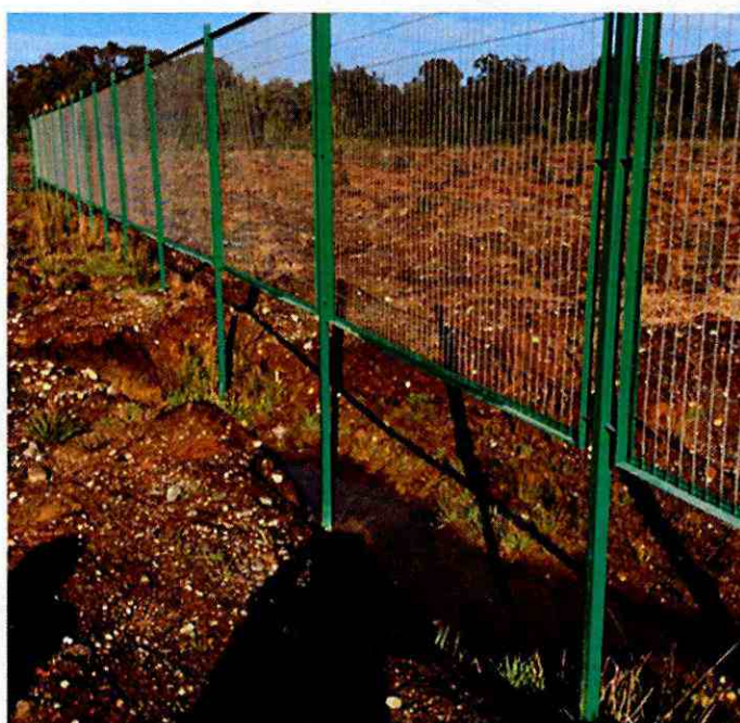
Imagen N° 8: Separación entre la base del cerco perimetral y el nivel natural del suelo, julio de 2017.
