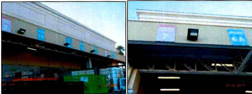
Imagen N° 3: Luminaria N° 3, sector patio de carga de camiones
