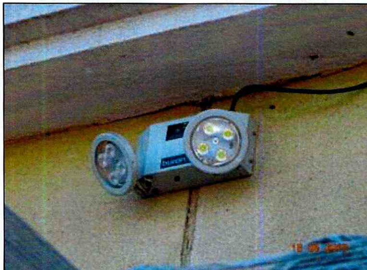
Imagen N° 5: Luminaria N° 21, sector patio de carga interior
