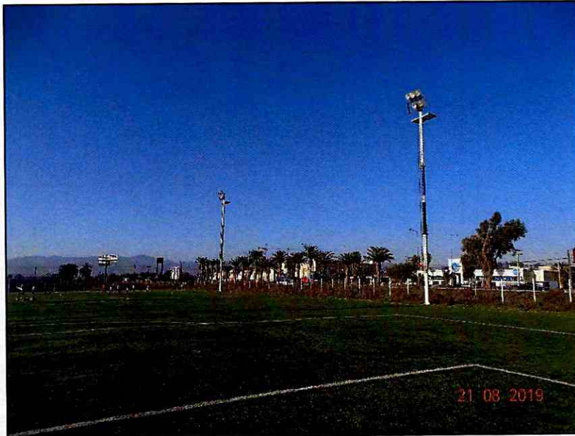
Imagen N°1. Vista general del sistema de alumbrado deportivo de las Canchas Toronto Eagles.
