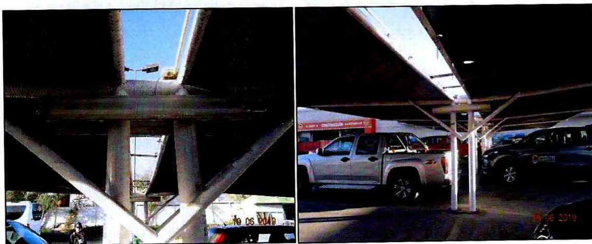
Imagen 7. Vista general y acercamiento luminarias N° 7, sector Easy.
