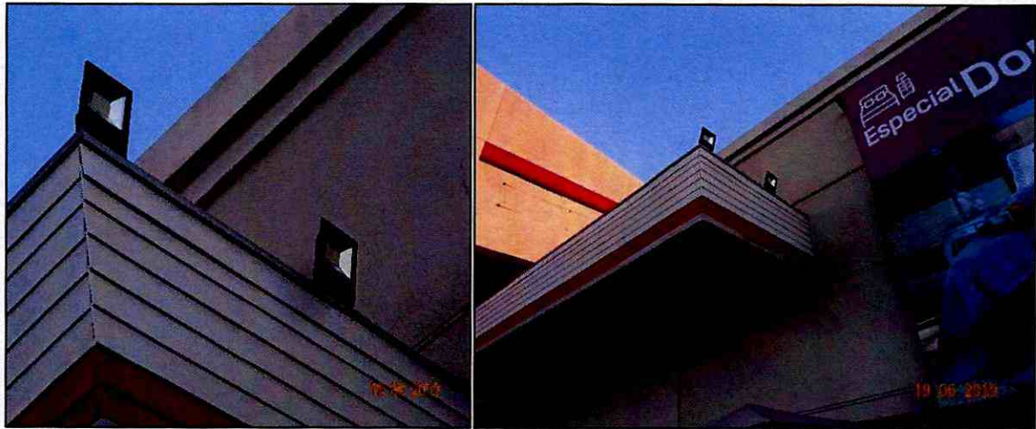
Imagen 8. Vista general y acercamiento luminarias N° 8, sector Easy.
