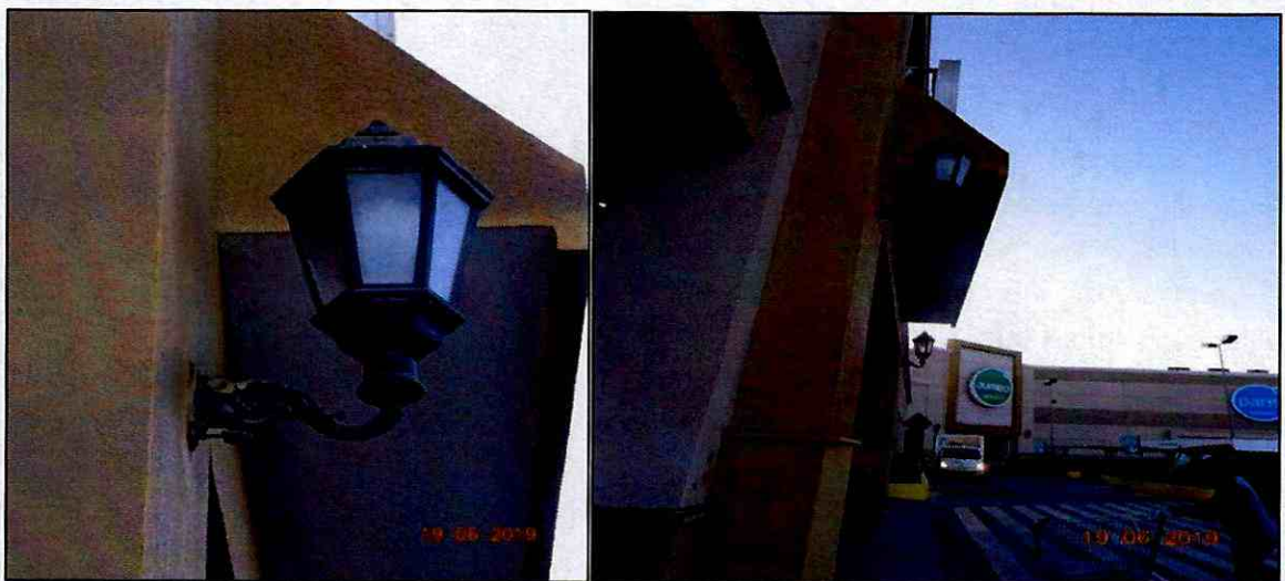
Imagen 10. Vista general y acercamiento luminarias N° 10, sector Jumbo.
