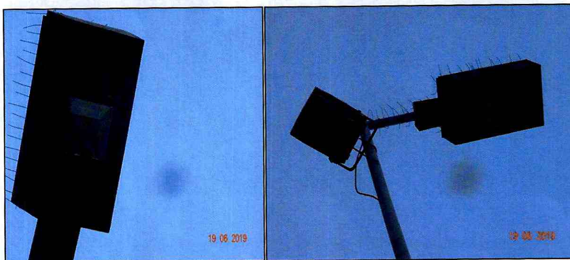
Imagen 12. Vista general y acercamiento luminarias N° 12, sector Estacionamiento.
