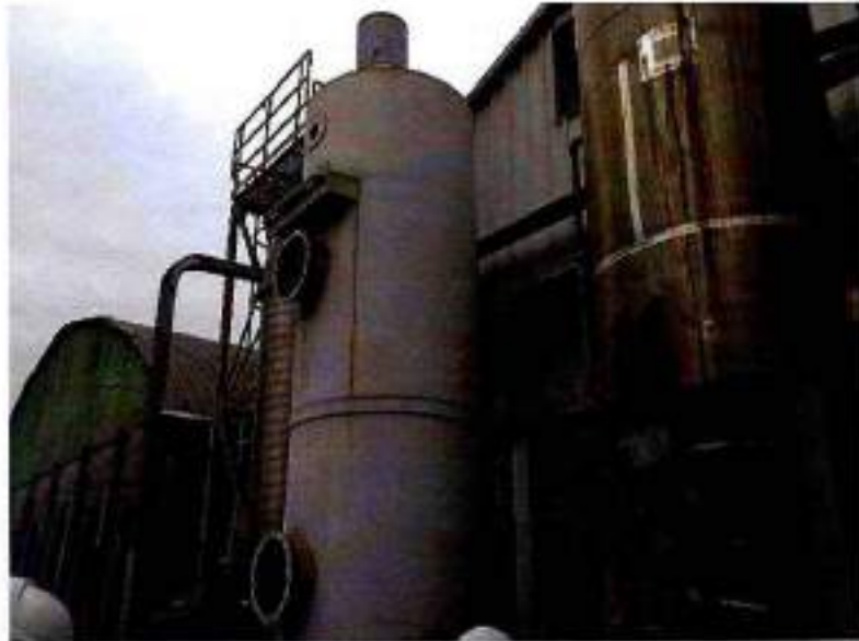
Imagen 4. Vista sistema de lavado de gases.
