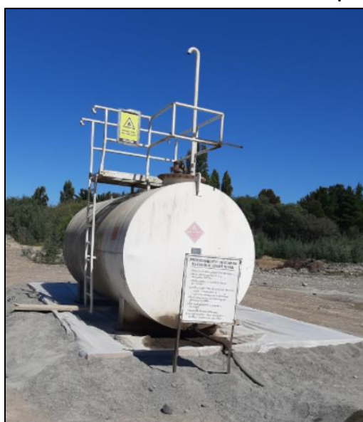
Imagen 6: Estanque de almacenamiento de combustible Diesel sin pretil de seguridad asociado
