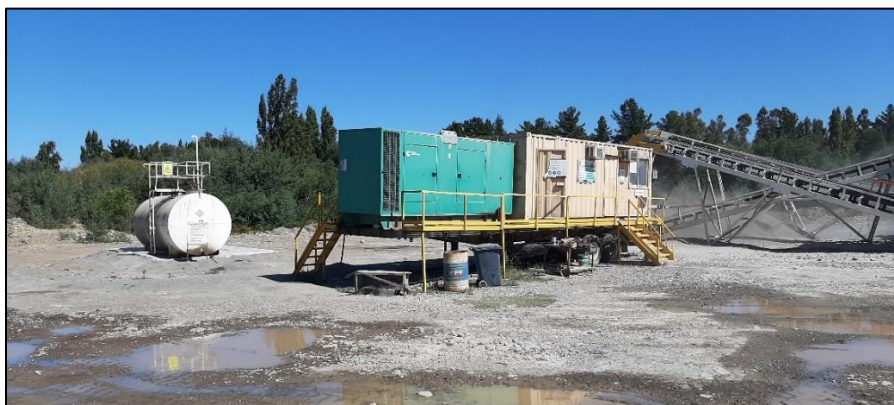
Imagen 5: Estanque de almacenamiento de combustible Diesel sin pretil de seguridad asociado
