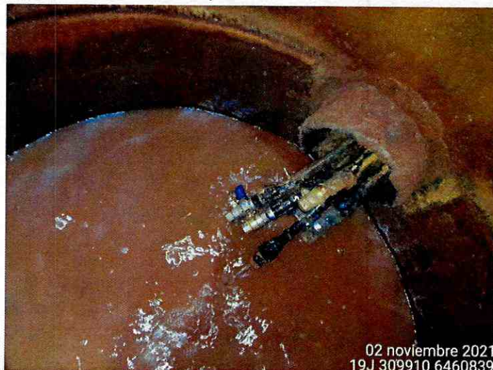
Imagen 4. Válvulas terminales en cámara de inspección del Sistema de detección de fugas en piscina TK-10
