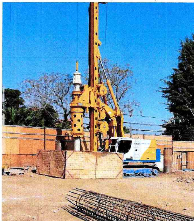
Imagen 1. Medida correctiva implementada por el titular
