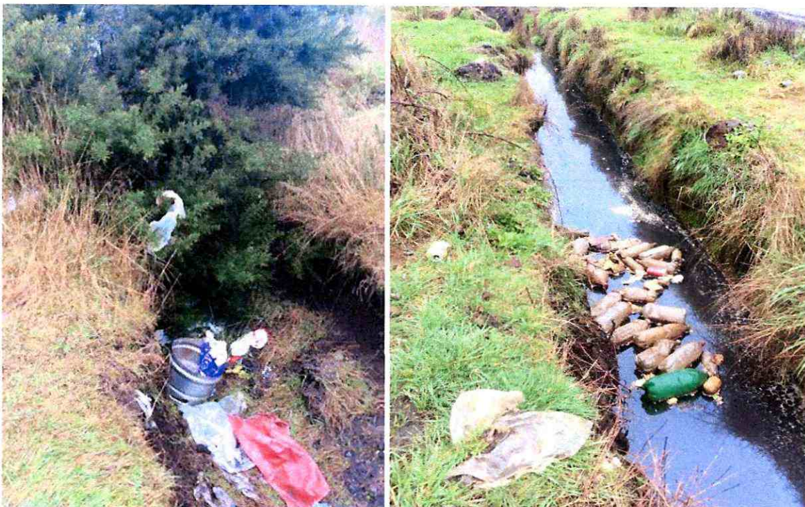
Imagen 4. Zanjas provisorias con presencia de residuos y vegetación (izquierda) y con presencia de residuos, plásticos y lixiviados (derecha).
