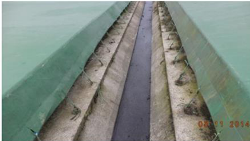
Fotografía 2. Canales longitudinales de aguas lluvias en zanjas de co-digestión
