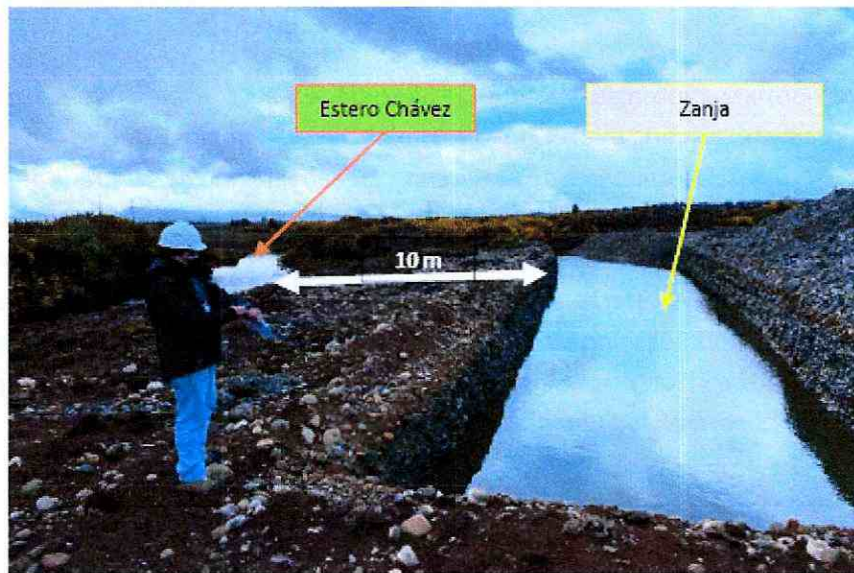
Imagen 2. Zanja rectangular a 10 metros del estero Chávez, obtenida con fecha 14 de octubre de 2021
