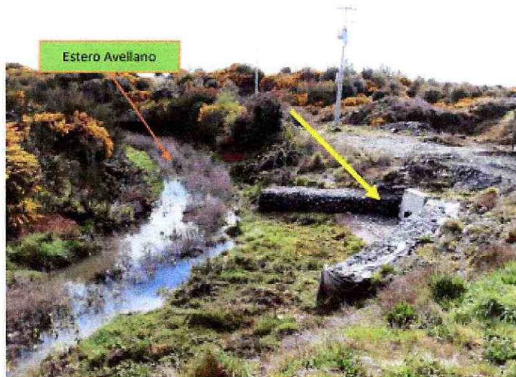
Imagen 5. Sector oeste de estero Avellano donde se encuentran las obras de canalización de aguas lluvias
