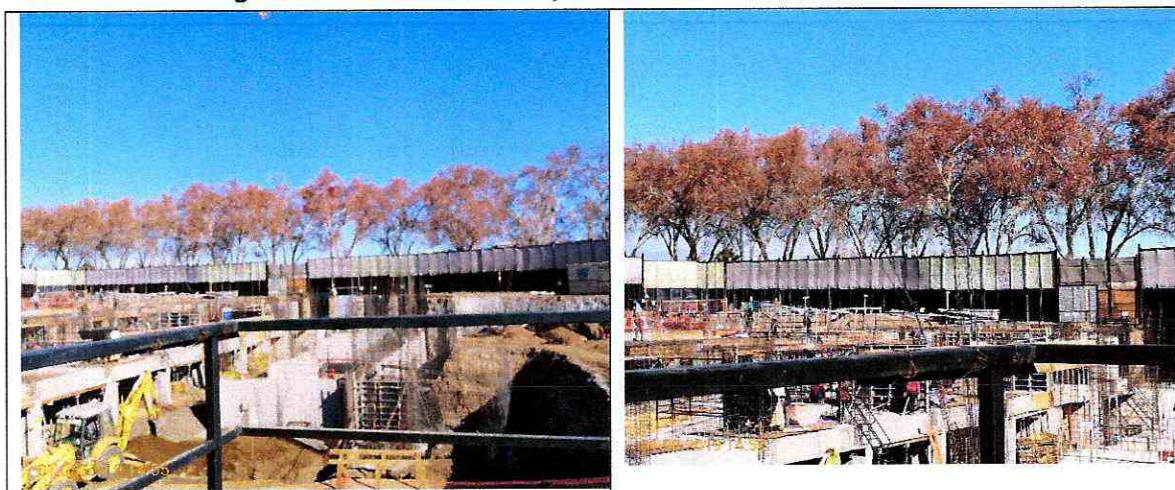
Figura 20. Pantalla acústica perimetral a faenas de obra gruesa
