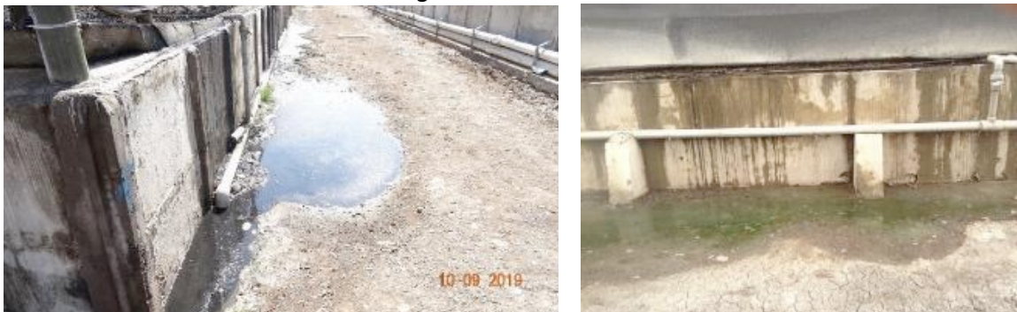
Set fotográfico N°1: Rebalse de RIL.
