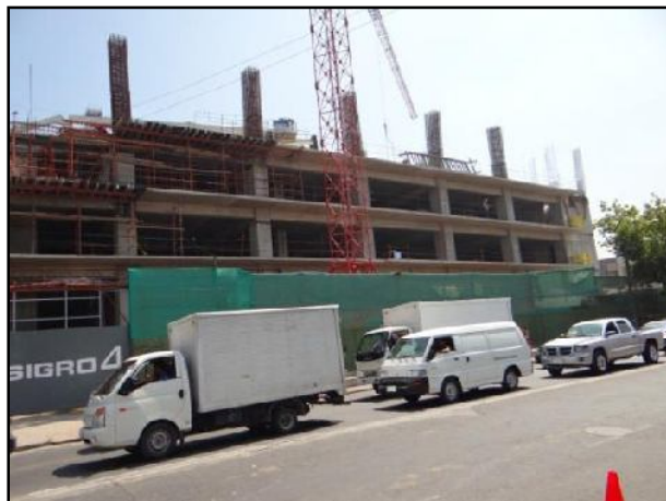
FOTOGRAFÍA 30 IIA CIERRE DE LOSA DE AVANCE, NO IMPLEMENTADO EN SECTOR SUR DE LA OBRA, INFORME DE INSPECCIÓN AMBIENTAL
