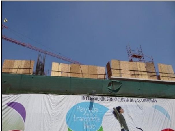
FOTOGRAFÍA 28 IIA CIERRE DE LOSA DE AVANCE SECTOR ORIENTE DE LA OBRA, INFORME DE INSPECCIÓN AMBIENTAL
