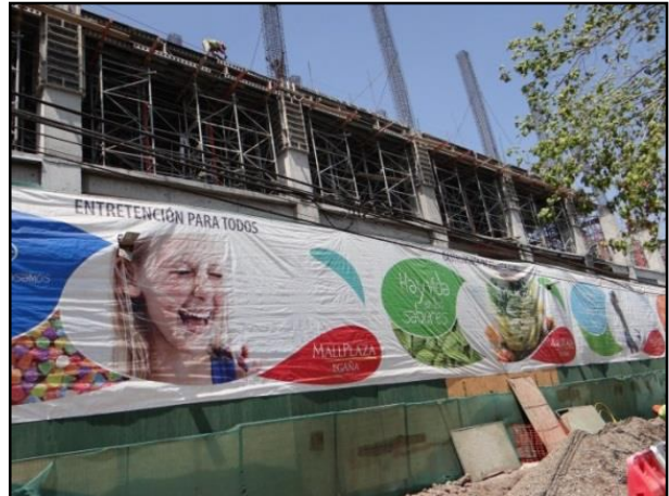
FOTOGRAFÍA 29 IIA CIERRE DE LOSA DE AVANCE, NO IMPLEMENTADO EN SECTOR NORTE DE LA OBRA, INFORME DE INSPECCIÓN AMBIENTAL
