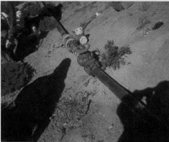
Fotografía 21: Conjunto Válvula y Flujómetro
