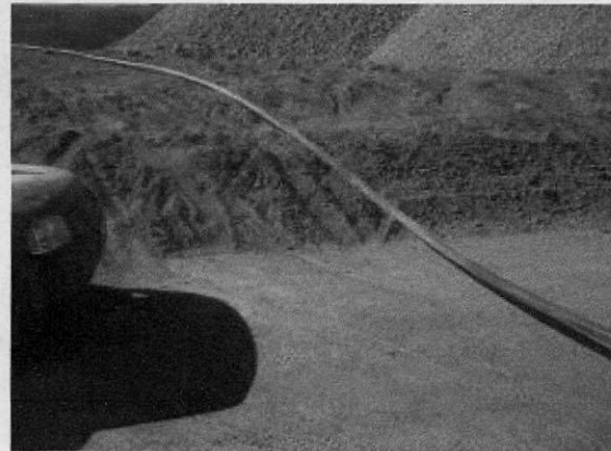
Fotografía 12: Línea HDPE en cruce camino minero
