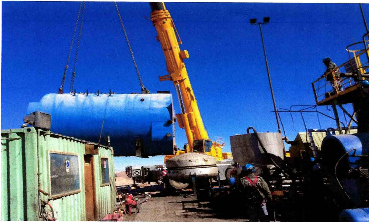
Imagen N°15 : instalación de calentador N°2 de refino
