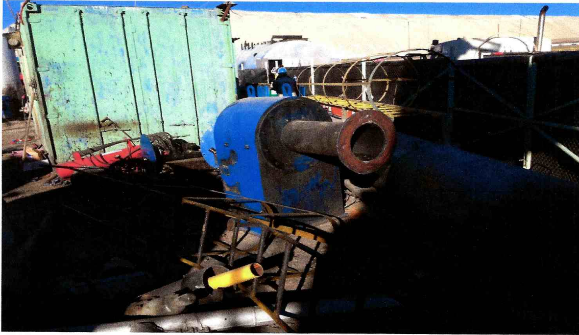
Imagen N°12 : retiro de conjuntos en general de componentes funcionamiento calentador
