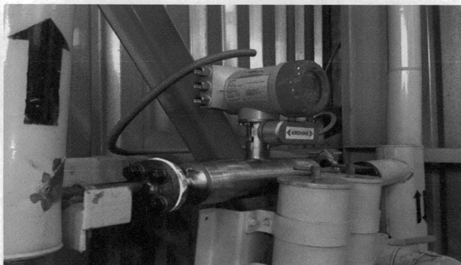
IMAGEN 7: flujómetro instalado en línea de alimentación diesel caldera planta.
