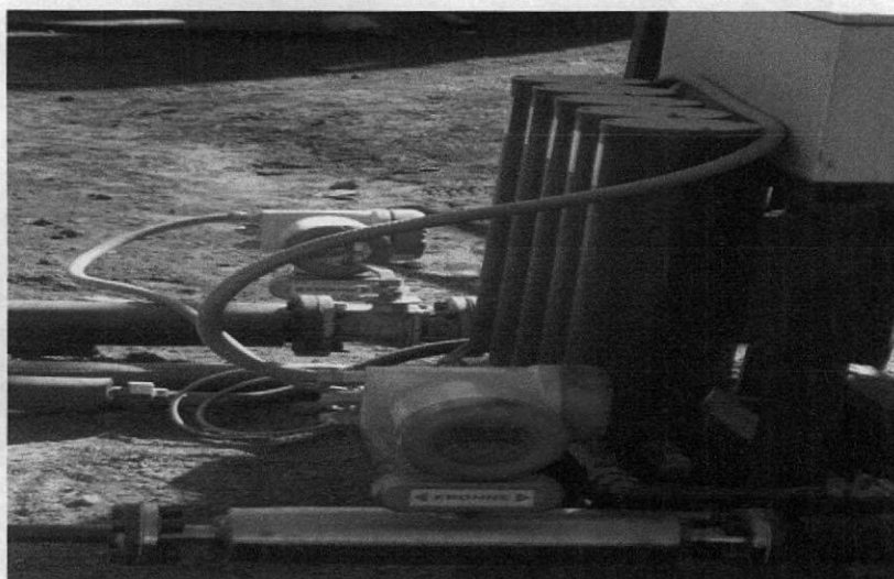
IMAGEN 13: flujómetros instalados en línea de retorno diesel y fuel oil N° 6 calentador 3 de refino.
