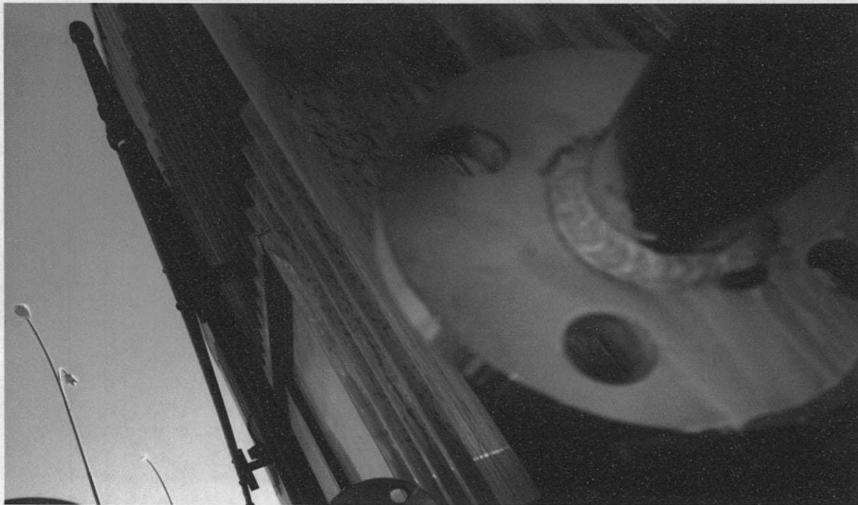
Imagen N°5: Instalación flujometros retorno bancker y retorno diesel calentador N°1 planta y fabricación e instalación de plataforma de lectura de
