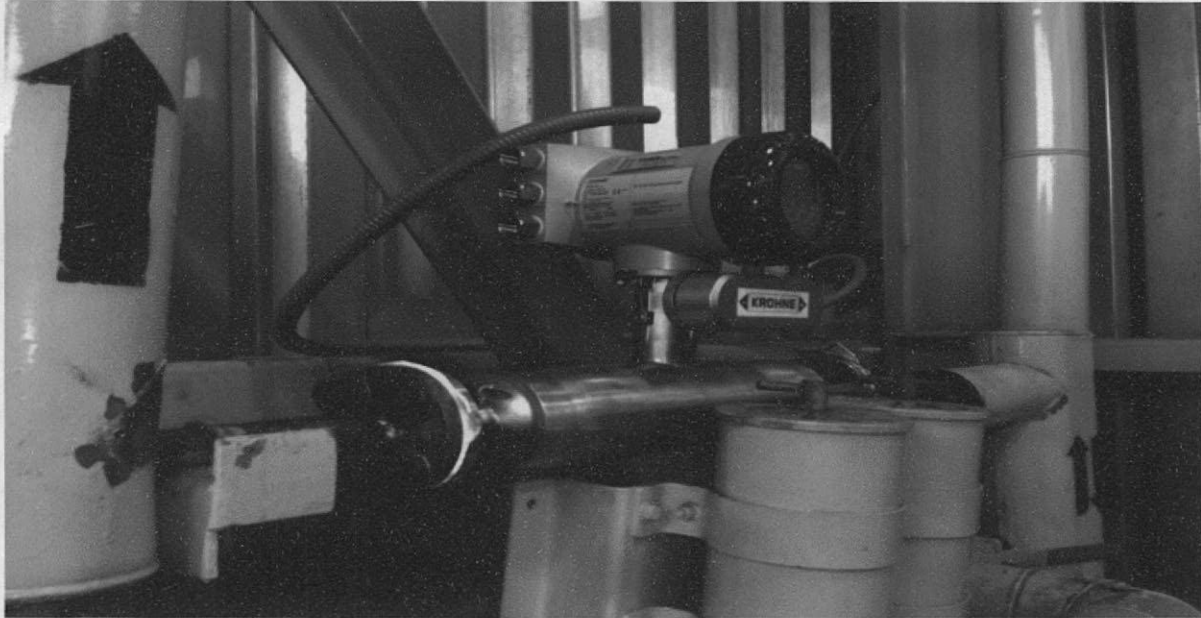
Imagen N°7: Instalación flujometro en línea de alimentación diesel caldera de vapor N°1 planta
