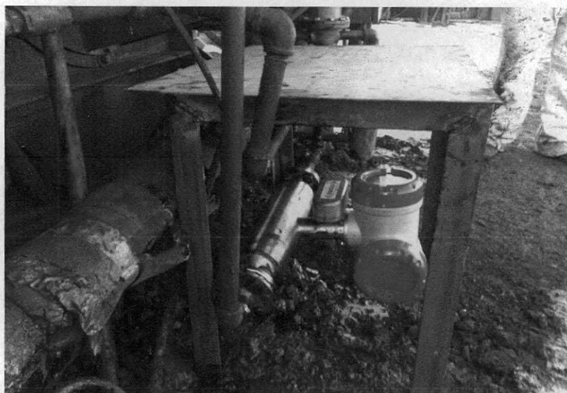
IMAGEN 12: flujómetro instalado en línea de retorno fuel oil N° 6 calentador 2 de refino.
