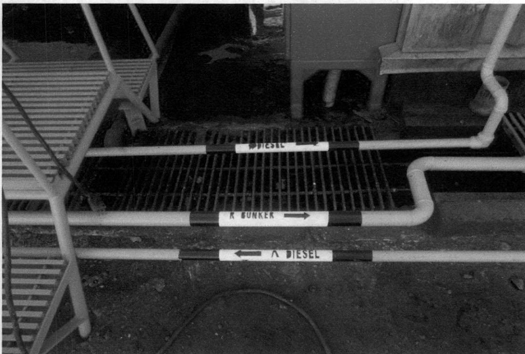
Imagen N°7: Estado actual de líneas Calentadores Planta.
