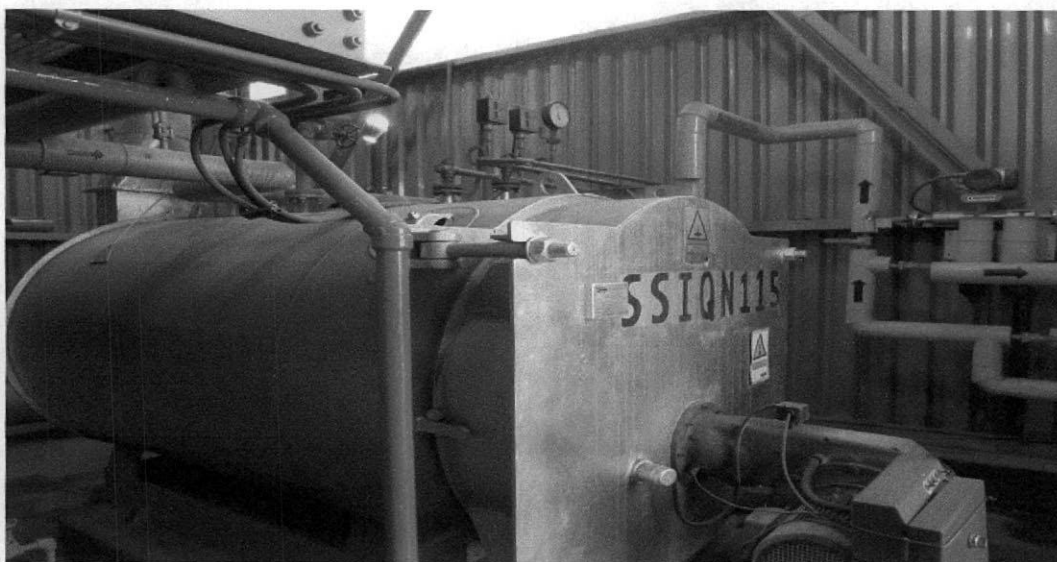
Imagen N°6: Estado actual de Caldera Planta
