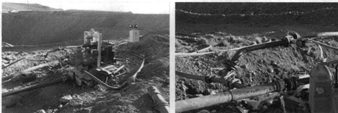
Imagen N°6: Bomba autónoma de impulsión y tubería nueva.
