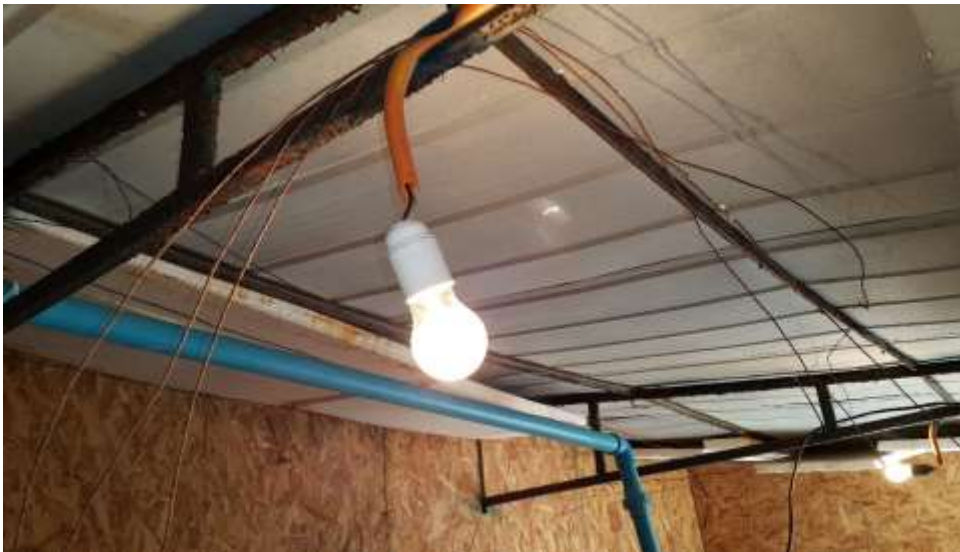
FOTO 3.- CUBIERTA INTERNA COBERTIZO, SIN AISLACION TERMICA. POLIESTIRENO.-
