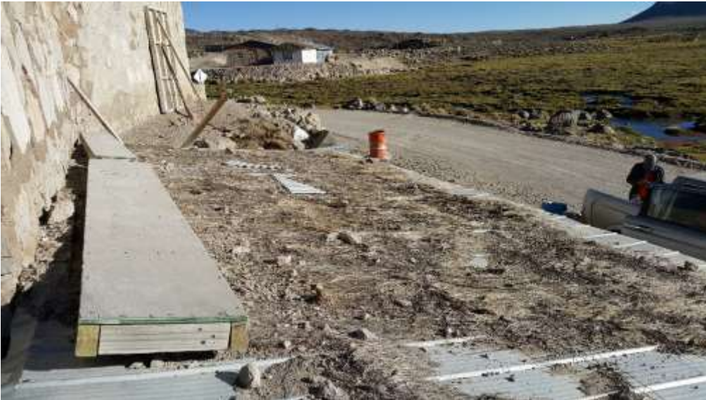
FOTO 4.- CUBIERTA EXTERNA COBERTIZO, SIN AISLACION TERMICA. COIRON.-
