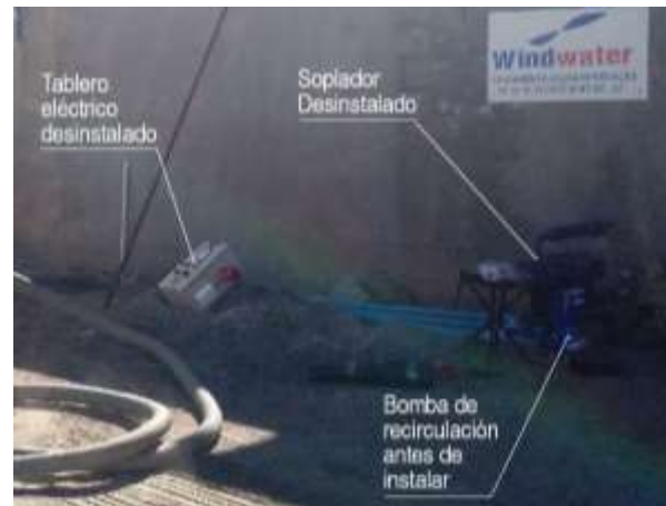
FOTO 6.- BOMBA DE RECIRCULACION
