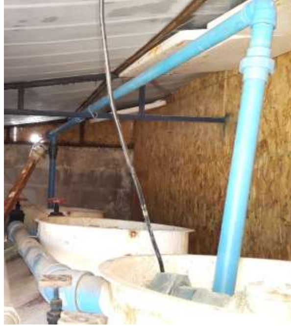
FOTO 6.- BOMBA DE RECIRCULACION
