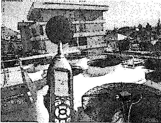
Parrilla de condensadores frente a tercer piso Edificio Latadia 4498.
