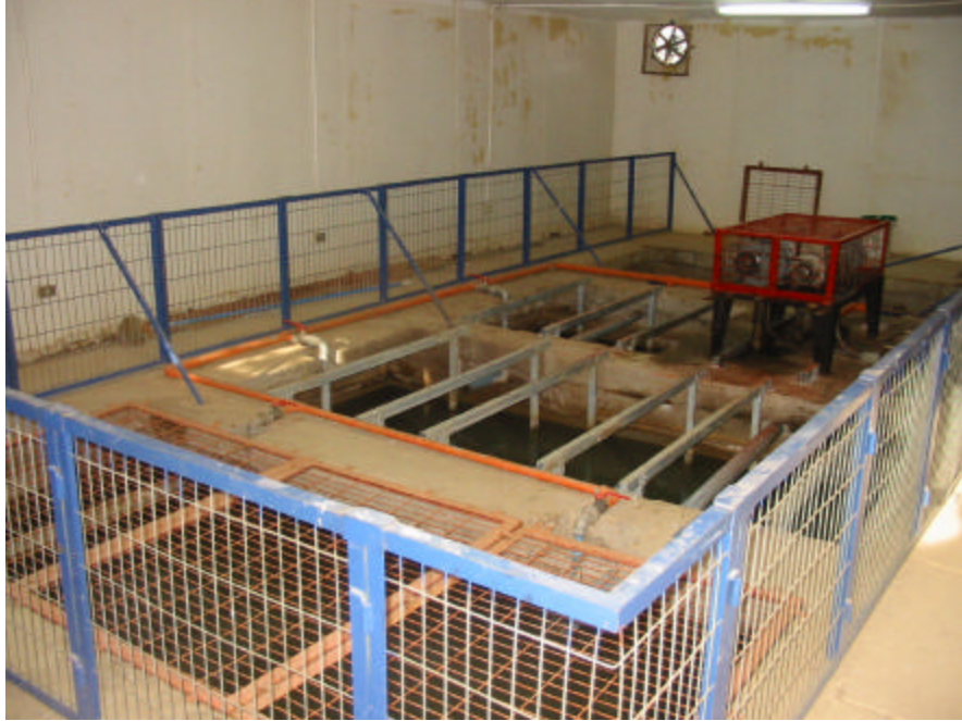
Piscinas de decantación, oxigenación y filtrado de Planta de Tratamiento de Aguas Servidas
