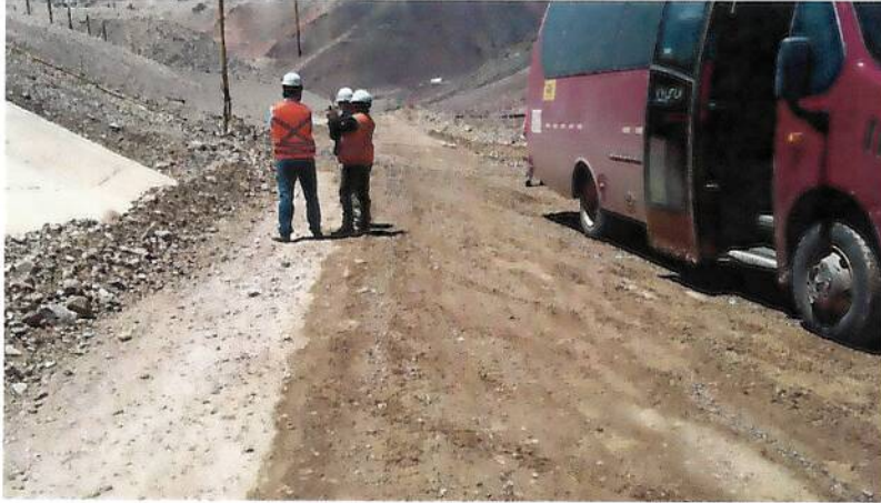
Imagen 15. Camino que se encuentra muy húmedo a un costado de la Subestación Vertedero de Emergencia.
