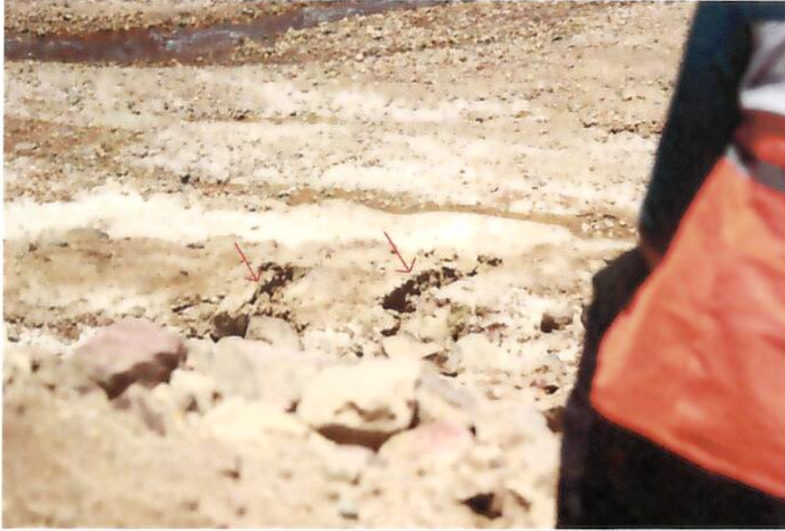
Imagen 23. Cárcavas en el talud hacia el Río Estrecho, evidencia de escurrimiento de aguas de contacto.
