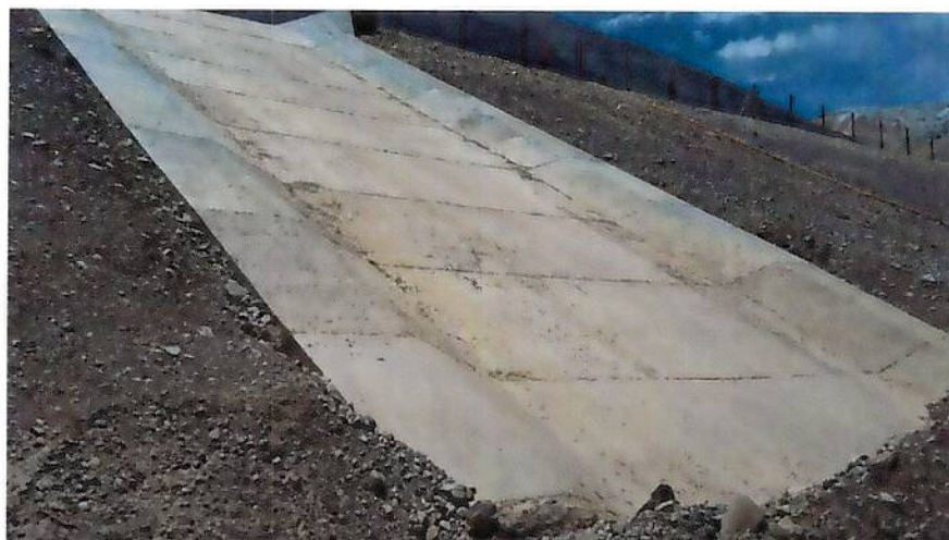
Imagen 21. Sedimento en la Subestación de Vertedero de Seguridad. Evidencia escurrimiento de aguas de contacto.
