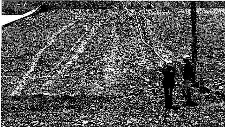
Imagen 18. Marcas de escurrimiento de aguas contactadas a un costado del Vertedero de Seguridad. Nótese la erosión dejada por el agua a un costado de la manguera y nótese las marcas del escurrimiento al costado izquierdo de la imagen.
