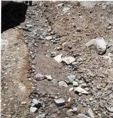
Imagen 16. Erosión dejada por el escurrimiento de aguas de contacto en el camino al costado de la Subestación Vertedero de Emergencia.
