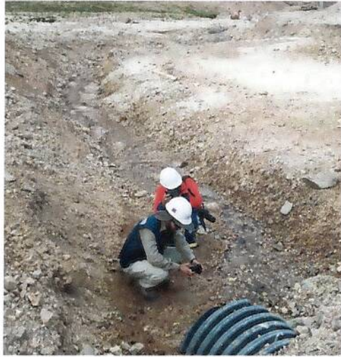
Imagen 11. Agua que proviene de una tubería a unos 20 metros al sur de la CCR.
