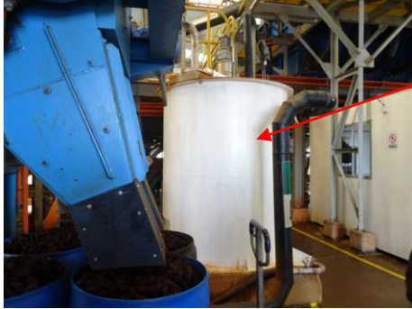
Estanque de lodos
