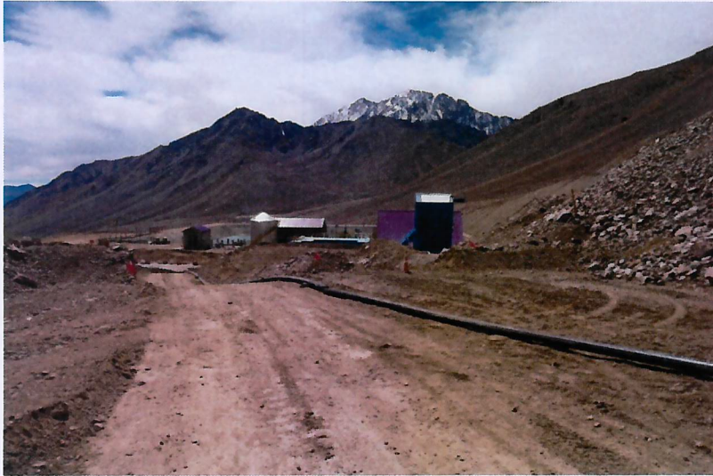
Presentación preliminar de cañería HDPE en salida desde Planta ARD en dirección a Piscinas de Acumulación
