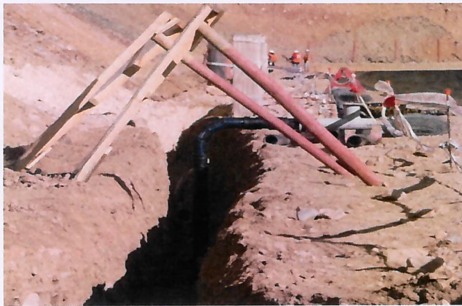
Salida de cañería en punto de descarga piscina N°1.
