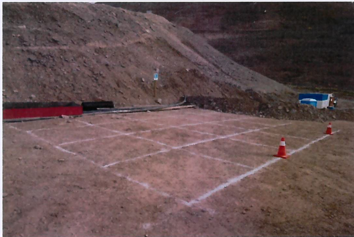
Trazado de malla de tierra a ejecutarse en sector entre piscinas #1 y #2, bajo futura "Sub-estación Piscinas"
