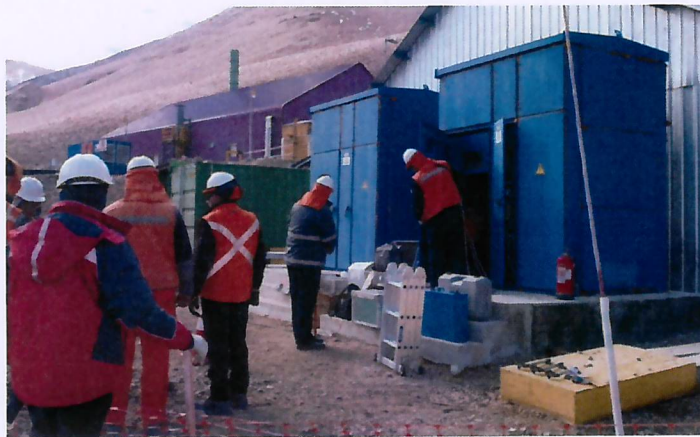
Pruebas en transformadores Casa de Fuerza Barriales
