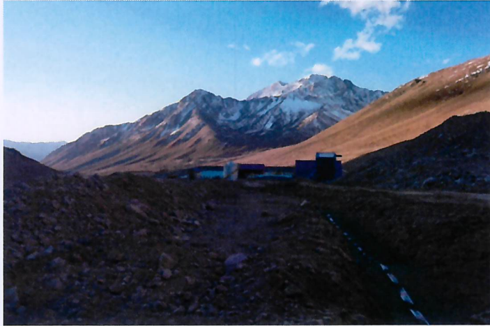
Tapado parcial por parte de Relix, de zanja compartida con tendido cable 23Kv. Tramo desde Planta Ard hacia piscinas de acumulación N°1 y 2.
